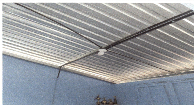
Foto 11: Sistema eléctrico nuevo en dirección
